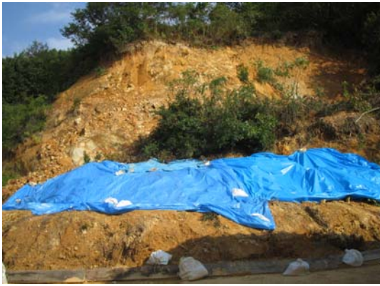
写真-3 虎仙窯の崩壊地 1
